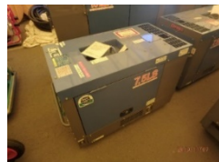
⑦可搬型発電機
