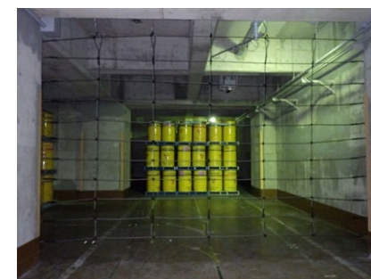
廃棄物容器が流出する可能性のある箇所へのワイヤーネットの設置
