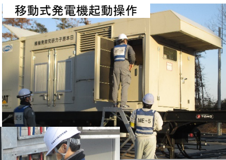
移動式発電機起動操作
