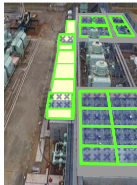
海水ポンプ室
