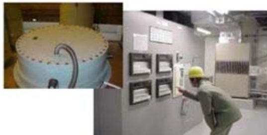
二重蓋間圧力監視(密封性確認)
