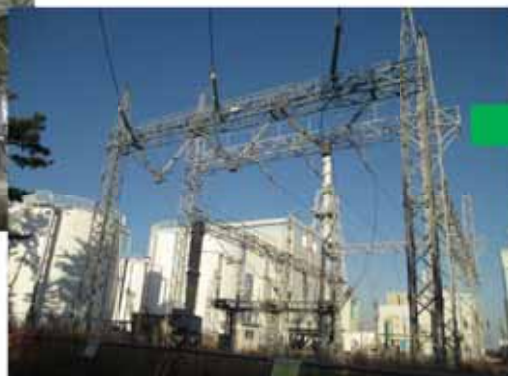
気中開閉所(取替前)
