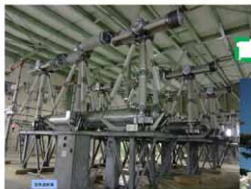
気中開閉所(取替前)
