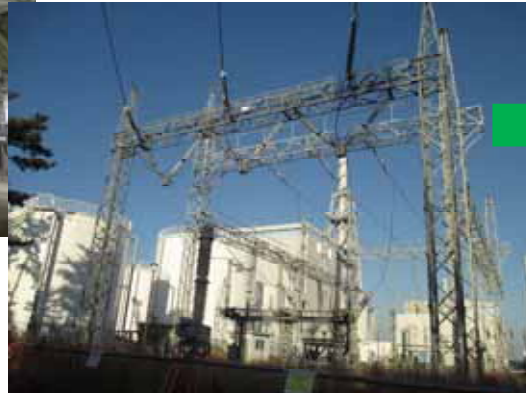
気中開閉所(取替前)
