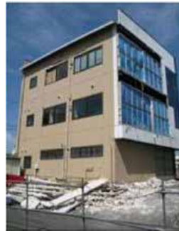
瓦礫は建屋周辺に堆積
