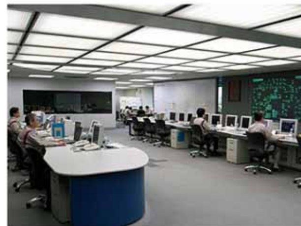
東京ガス(株) 供給指令センター
