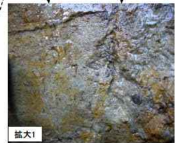
拡大1 一部に礫を含む砂岩中の断層面の連続性はやや不明瞭でしばしば分岐し、平面性は低い。
