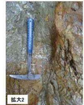
拡大2 ● 砂岩と泥岩の境界の断層面の連続性はやや不明瞭でしばしば分岐し、平面性は低い。また幅約5mmの砂礫岩を挟在しているが、粘土状破碎部を伴わない。 ● 砂礫岩は、周囲の砂岩層と同様の固結の程度である。
