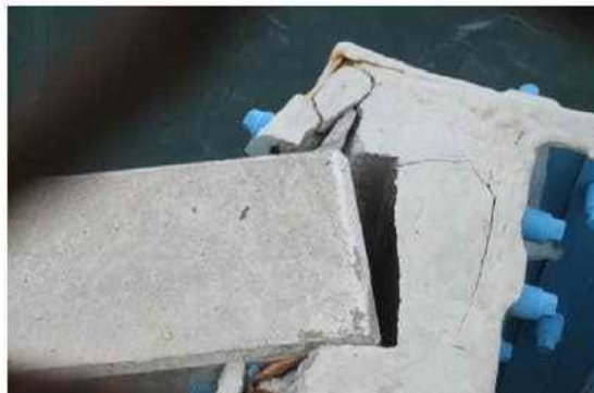
写真③: 躯体の変形
