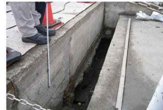
写真⑤: 地盤沈下に伴う段差の発生(取水口エリア)
