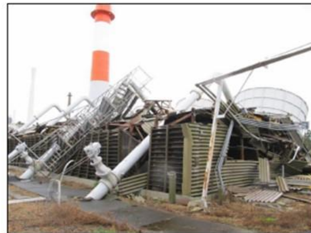
冷却塔倒壊後(R1.9.9撮影)
