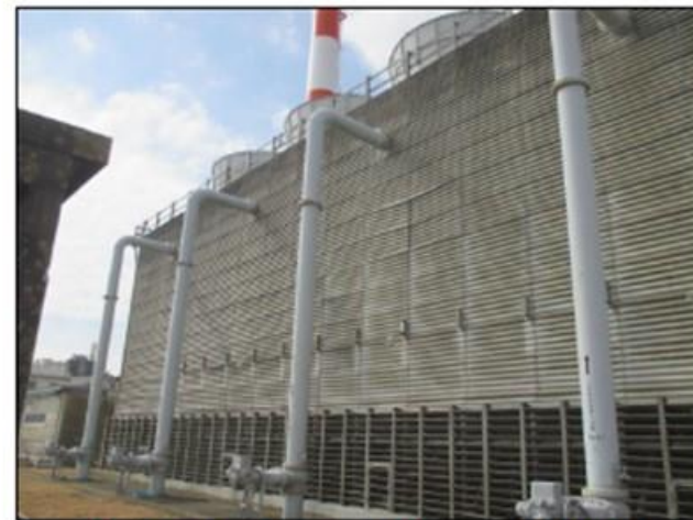
冷却塔倒壊前(H30.2.16撮影)
