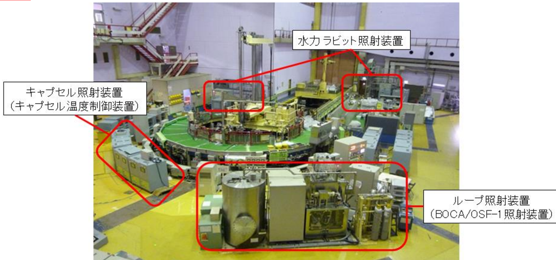
原子炉建家1階の状況
