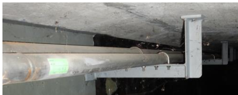
廃液輸送管外観写真
