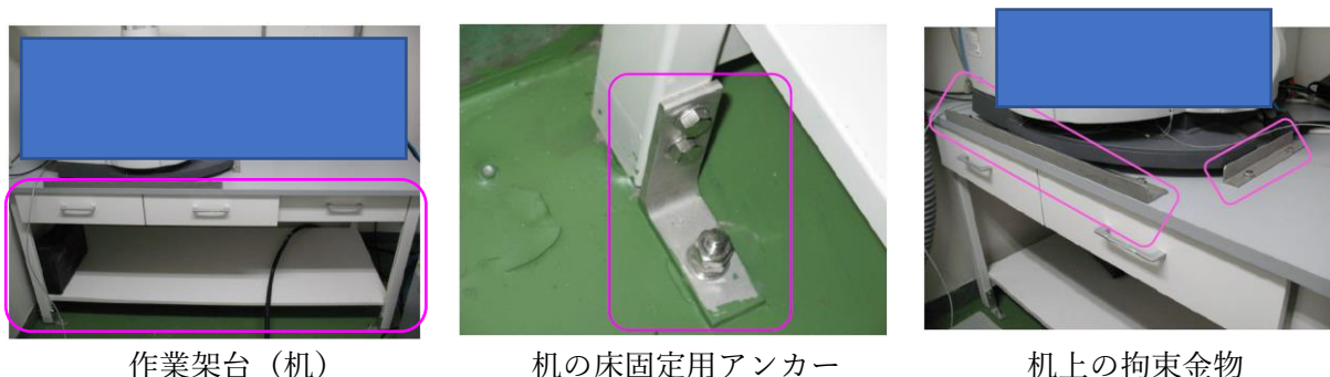
図 2 - 1 分析設備に関する作業架台（机）、床固定用アンカー及び机上の拘束金物
