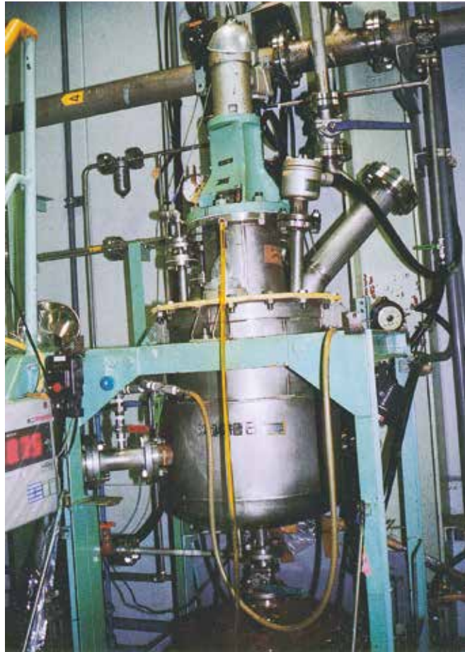
事故が起きた沈殿槽
