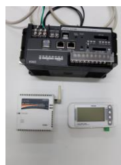
電力監視システム
