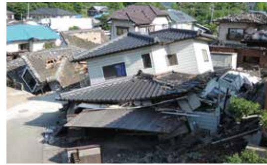
地震による被害例（熊本地震）
