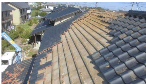
被災した住宅(屋根瓦の剥落)
