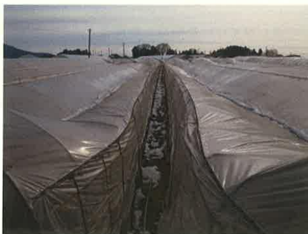
図4 雪によるパイプハウスのM字型陥没
